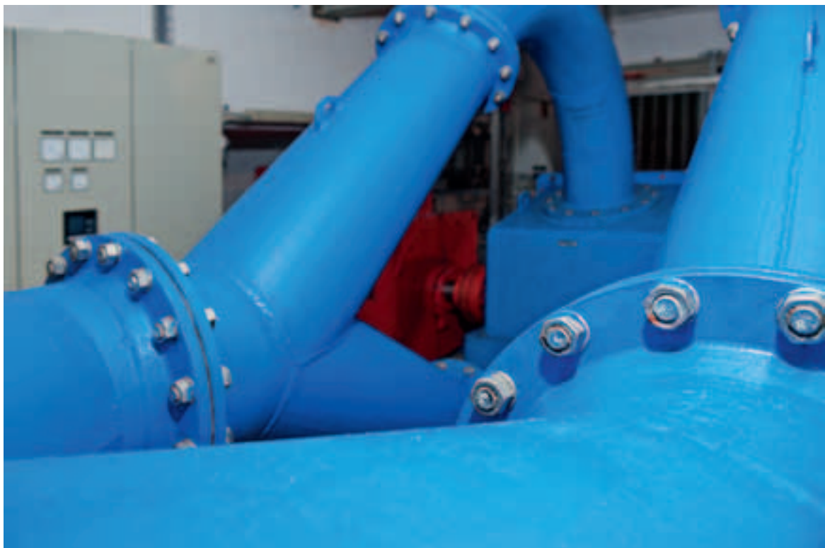
Druckleitung im Turbinenhaus
